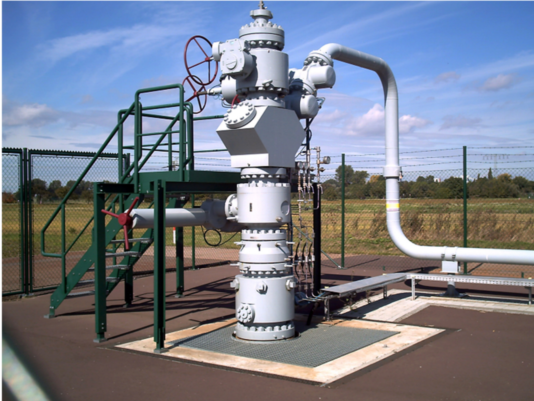
Figure 2 : Tête de puits d'un stockage de gaz naturel (Source : Hartmann Valves)
